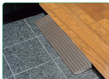
玄関(あがりかまち)の段差
