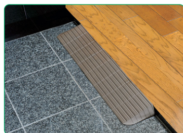
玄関(あがりかまち)の段差
